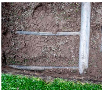
Abb. 2: Osmo-Drain zur Belüftung in Köln.
